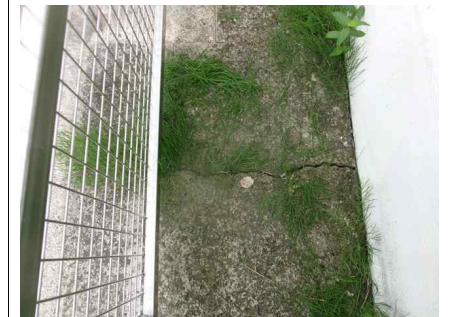
<검수실 외부 바닥 균열>
