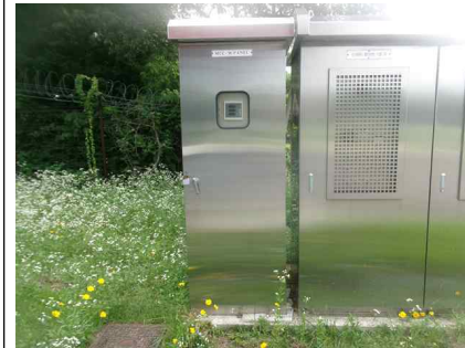
<외부 현장제어반 상태양호>
