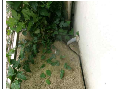
<검수실 외부 바닥 파손>
