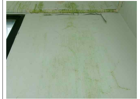
<검수실 내부 벽체 망상균열>
