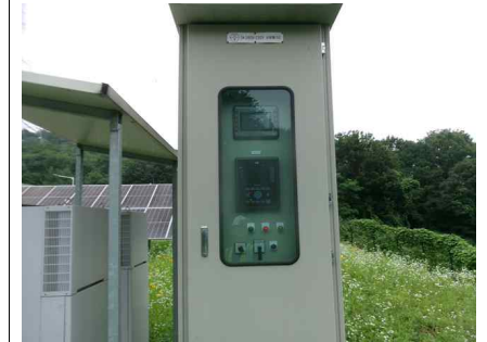
<전기실 전기설비 상태양호>
