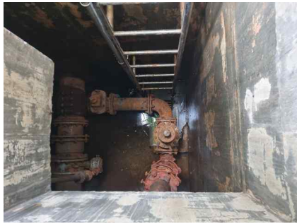
<유입밸브실(1지) 바닥슬래브 체수>
