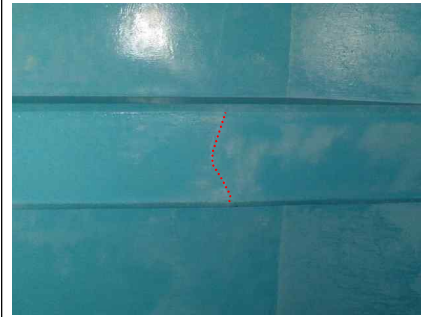
<2지 상부슬래브 균열>
