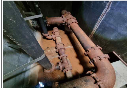
<기계설비(밸브 및 배관) 전경>
