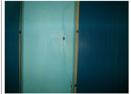
<2지 기둥 균열부 백태>
