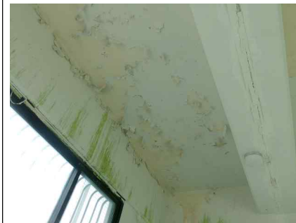
<검수실 내부 상부슬래브 도장박리>
