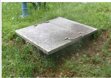
<환기구 등의 덮개( 장비 반입구) 전경>
