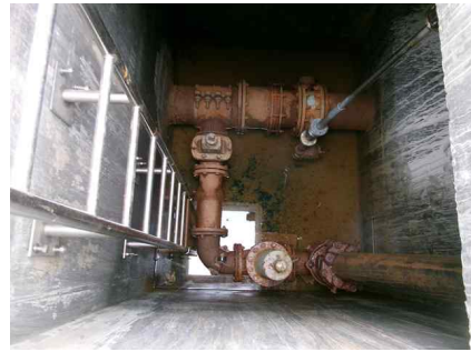
<유입밸브실(2지) 바닥슬래브 체수>
