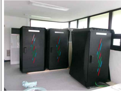
<관리동 내부 전기설비 상태양호>
