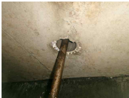
<유입밸브실(2지) 상부슬래브 백태>
